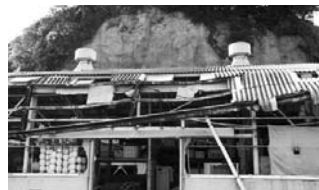
いまだに震災での津波被害を受けたままの状態になっている漁港(茨城県平潟港)
